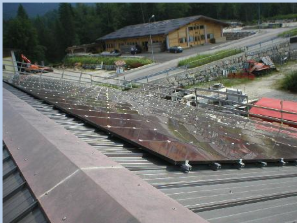
Impianto su tetto a Lavarone, p= 30 \text{ kWp}
