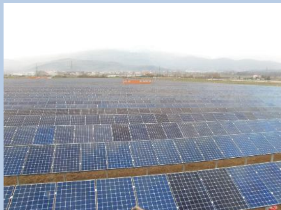
Centrale fotovoltaica P=2479 \text{ kWp} Con due cabine MT/bt in provincia di L'Aquila
