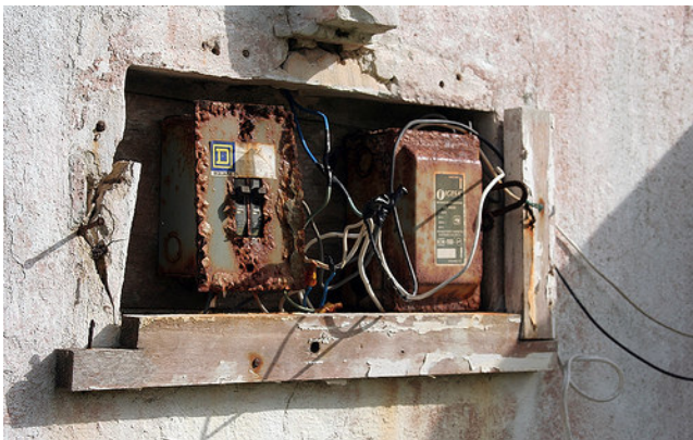
Impianto, ancora funzionante, ma che necessita, forse, di una "piccola" verifica!
