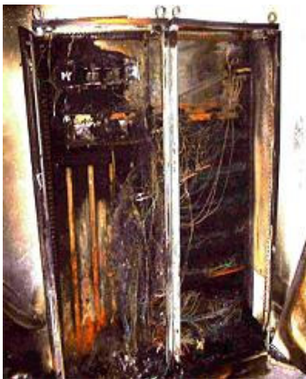
Incendio in quadro elettrico, generato da difetti d'isolamento dei cavi.
